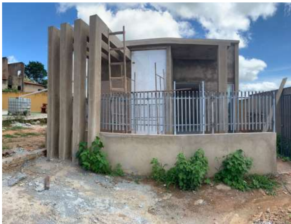
FIGURA 2 – Prédio em construção do futuro Centro de Especialidades em Saúde de Bernardino Batista-PB
